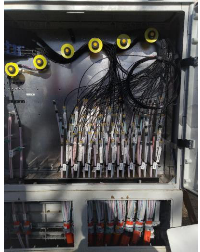
Kabelverzweiger von innen
